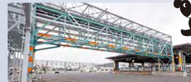
▲高潮対策工事(嵩上げされた電気配線)
